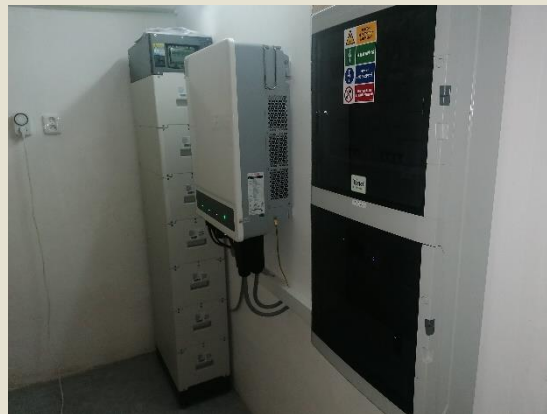
Rozvodna a umístění panelů
